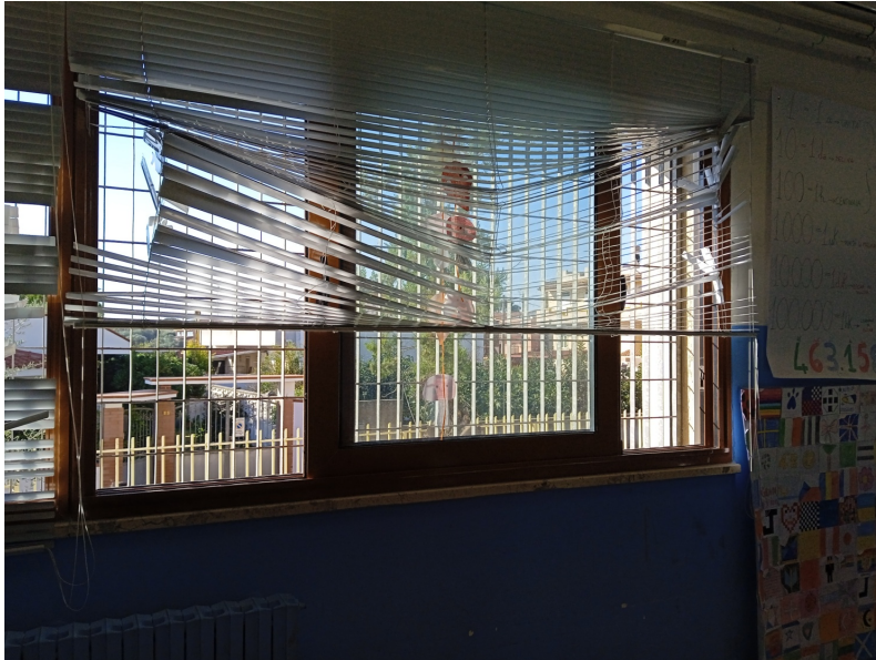
Foto: Immagine di una delle finestre del locale n.12 con all'interno una delle veneziane da sostituire
