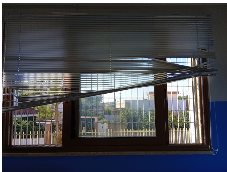
Foto: Immagine di una delle finestre del locale n.11 con all'interno una delle veneziane da sostituire
